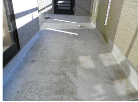
2 FRP防水藻の繁殖・経年劣化 工程↓ 高圧洗浄・目荒らし・脱脂作業 改修用エポキシプライマー1回塗り トップコート1回塗り
